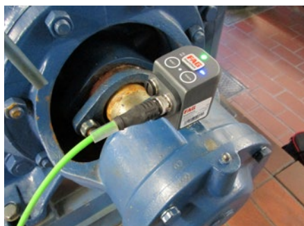
Los sensores del FAG SmartQB monitorizan el estado de las bombas del equipo
