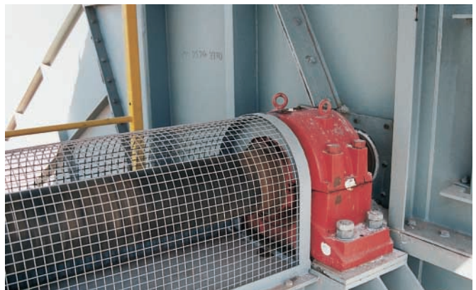
Unidad motriz de un ventilador
